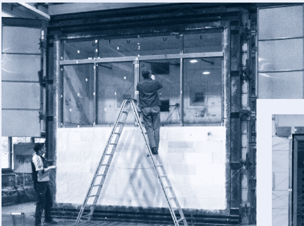
Aufbau einer 4-teiligen EI30-Anlage mit Oberlicht im Prüfinstitut. Montage d'une installation EI30 à 4 éléments avec partie supérieure à l'institut de certification.
